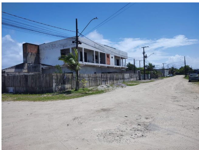
Figura 2 Edificação lote 195 A obra parada, sem trabalhadores.
